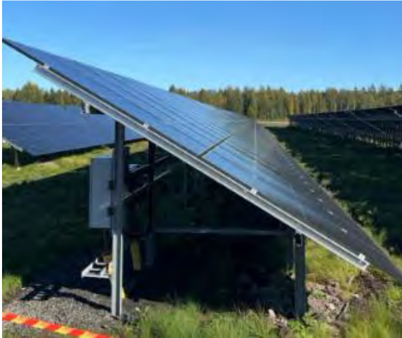
Kuva 8. Omien perustusten varaan asennettuja aurinkopaneeleita (Sitema Oy)
